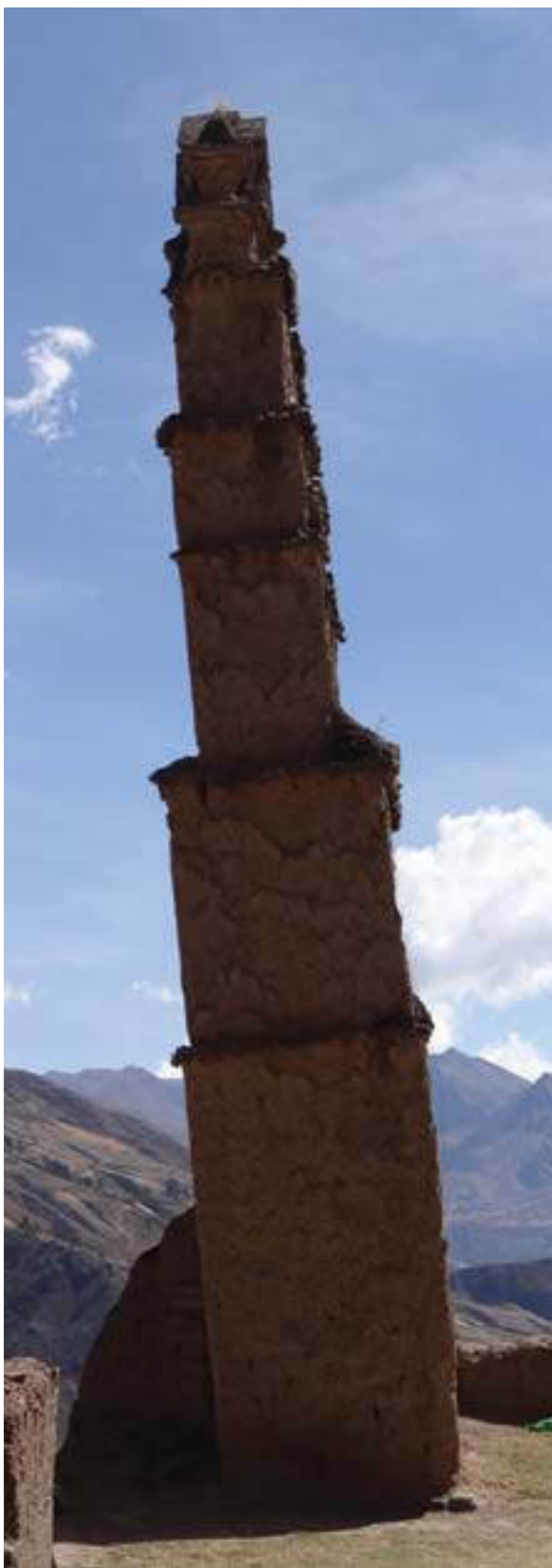
Espadaña inclinada de Mohoza
